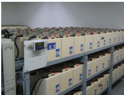
BACS- Installation mit insgesamt 540 Batterien (6 V 150 Ah)
