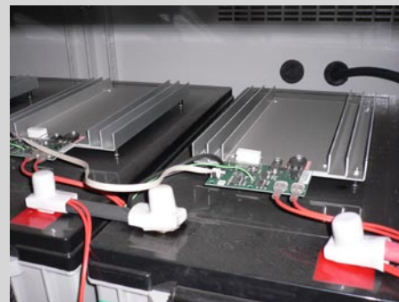
In Batteriestrang eingebaute Module
