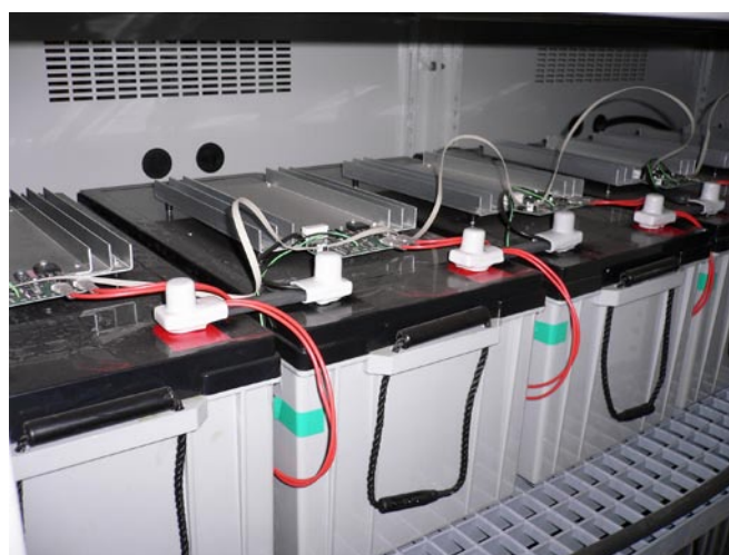
Detailansicht der Einzelmodule. Erkennung und Tausch einzelner defekter Batterien problemlos möglich.
