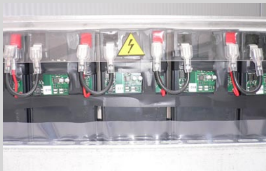
In einen Batteriestrang eingebaute Module
