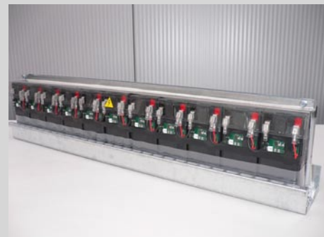
Batteriestrang auf Schiene für den Einbau in eine USV Quasar vorbereitet
